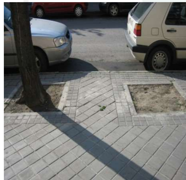
EJEMPLO DE MARCO DE PLANTACIÓN INADECUADO
